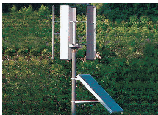
太陽光発電とジャイロミル型風車を利用した夜間照明装置
