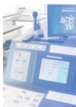
教卓にあるAV機器コントロールパネル
