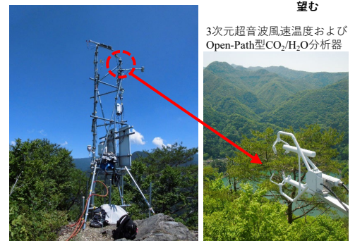
水上演習林 (標高: 985 m) に建設された気象観測塔 (左側) とその先端で計測しているCO 2 吸収・放出の観測状況 (右側)
