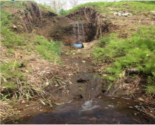
水路分断箇所
