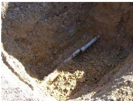
接合部の外れていた集排の管 ( 12 月 3 日 )
