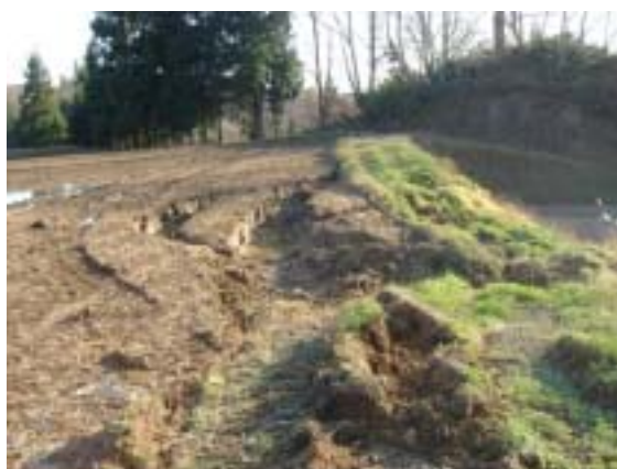
崩壊した農地(12月3日)
