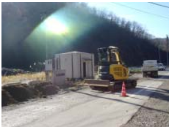
向山中継ポンプ場 ( 12 月 3 日 )
